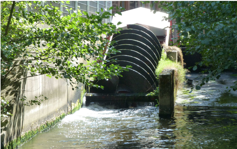
Abb. 6: Die Wasserkraftschnecke am Ortseingang von Lohr
